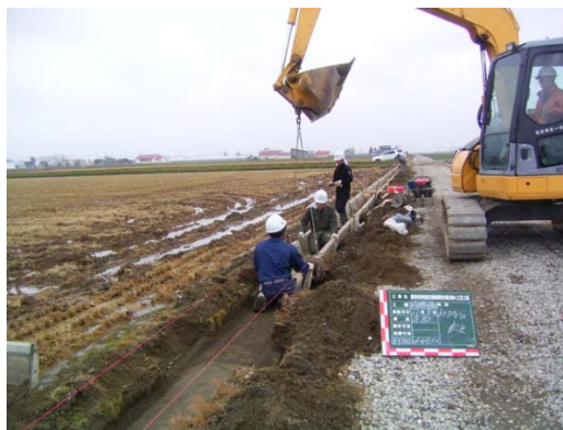
揚水機場の分解補修(左)、用水路のトラフ布設替え(右)に農業基盤整備資金を活用
