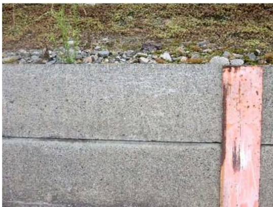
柵板の微細な網目・亀甲状ひび割れ
