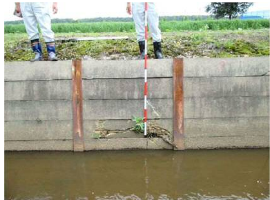
柵板剥離・剥落
