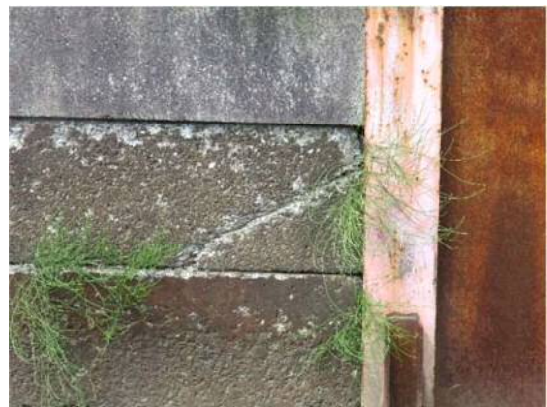
ひび割れ状況
