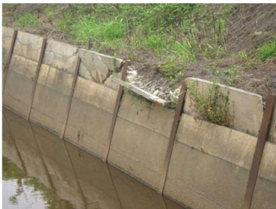
SP200(R) 柵板破損、ひび割れ・剥離
