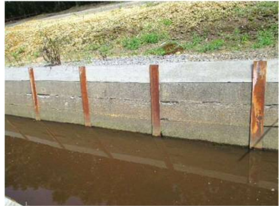
柵板ひび割れ・剥離（上から 2・3 段目）
