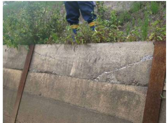
SP180(L) 柵板ひび割れ・剥離
