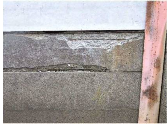
柵板剥離・剥落
