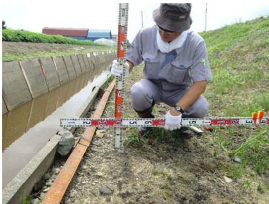
裏込砂利沈下状況
