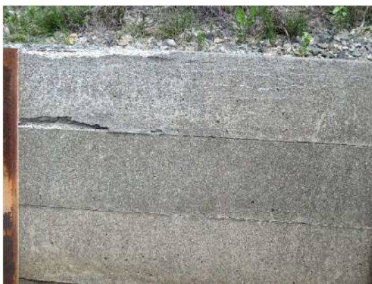
柵板ひび割れ・剥離
