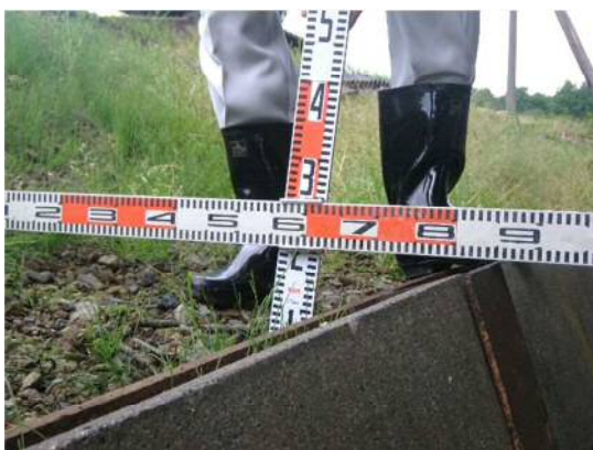
SP350(L) 裏込砂利沈下
