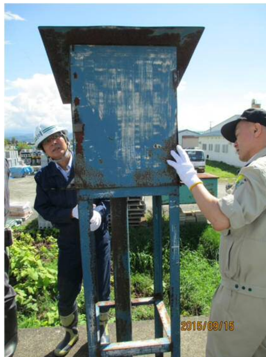
水位計の破損
