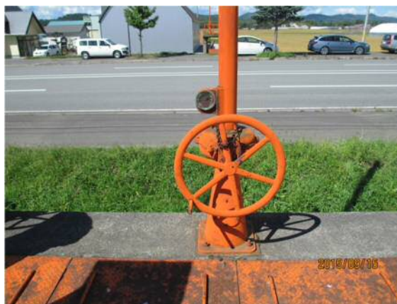
開度計の破損
