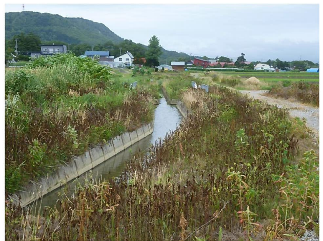
雑草の繁茂状況
