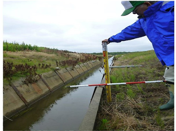
砂利の沈下状況(40cm程度)
