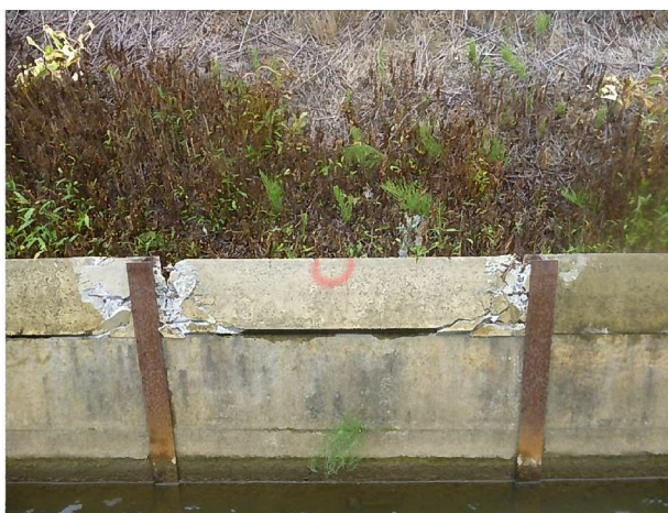
PC版の破損状況
