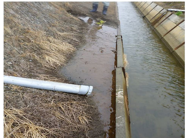
柵渠背面の滞水状況
