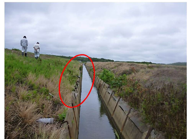
破損状況全景
