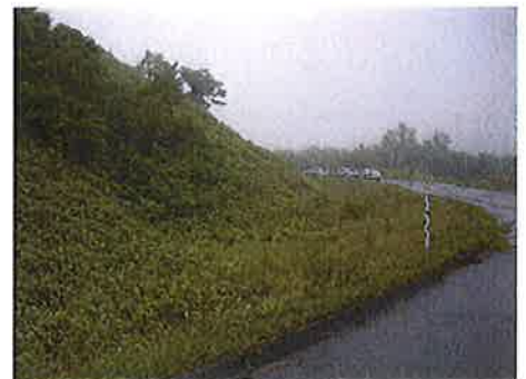
【ザリガニがいた斜面の状況】
