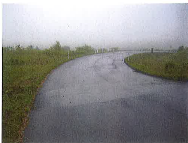
沈下区間の上方から下方
