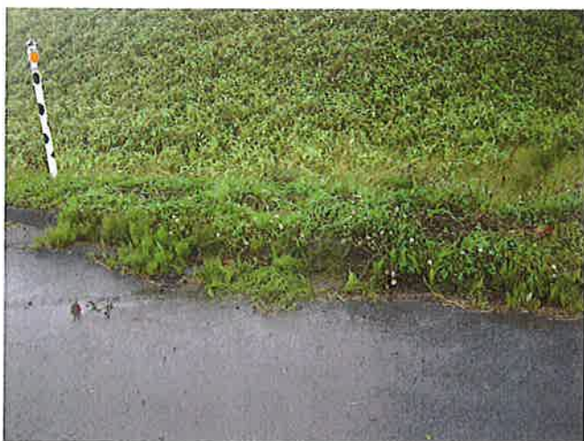
沈下区間の路面沈下状況
