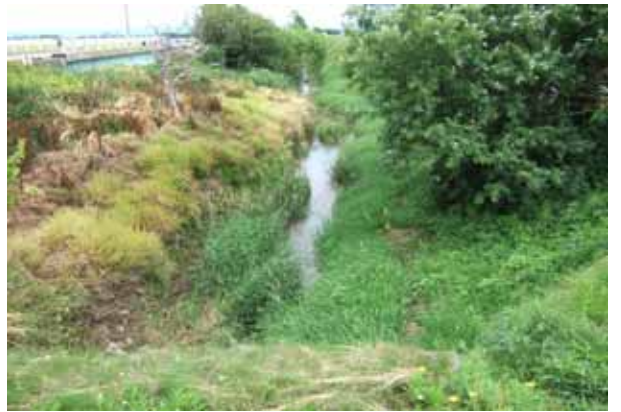
SP 3000 付近の町道橋から下流方向へ 法のはらみ・土砂の堆積状況
