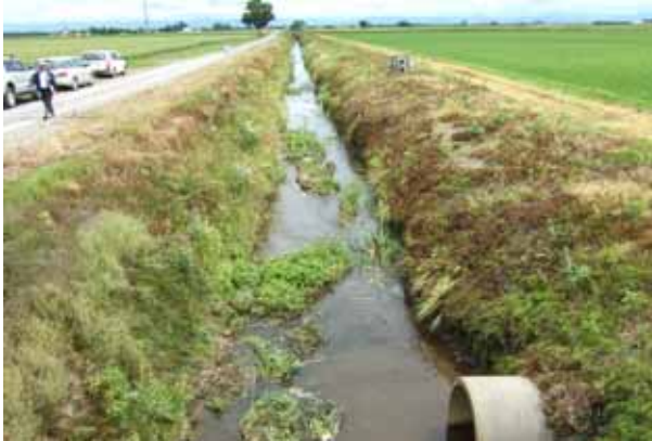
終点側（国道 275 号側）から下流方向 法のはらみ・土砂の堆積状況
