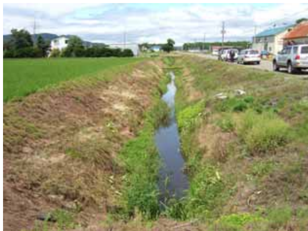
農地取付橋から上流方向 法のはらみ・土砂の堆積状況
