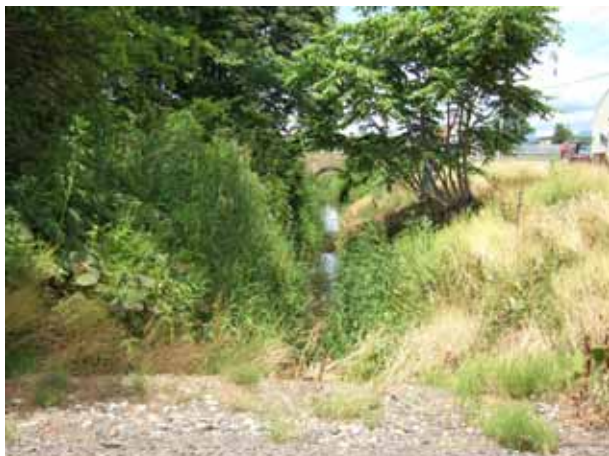
北 8 号より 3 5 0 m の宅地取付橋から上流方向 法のはらみ・土砂の堆積状況
