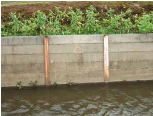
終点より 5 0 0 m 付近の L 側の柵渠 コンクリートの剥離状況
