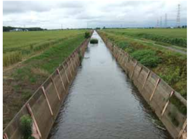
終点より 5 0 0 m の町道橋より下流方向 法の崩れ
