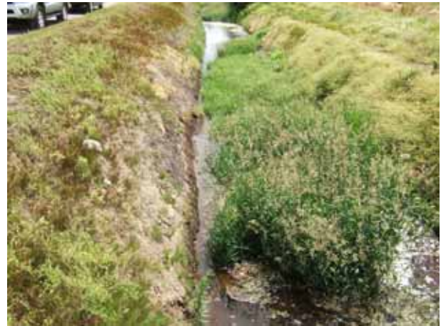
終点側の農地取付橋から下流方向 土砂の堆積状況
