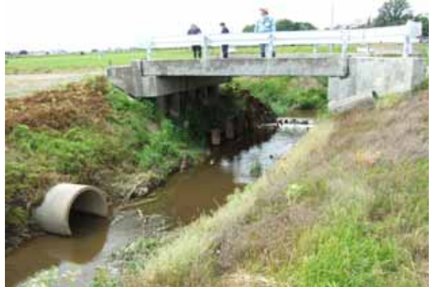
下流側から終点（国道 275 号）方向 排水の滞留している状況
