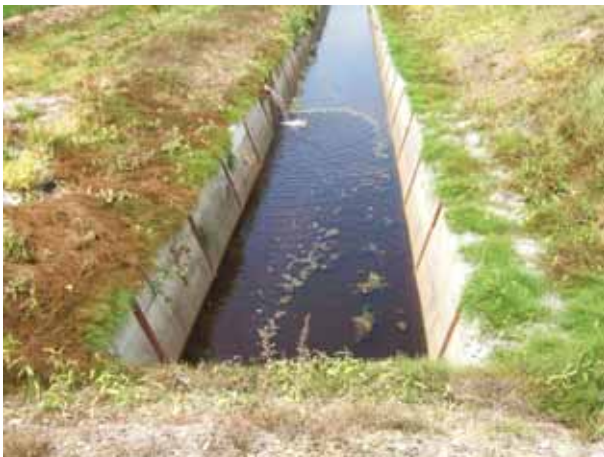
終点側の農地取付橋から上流方向 下流の土砂の堆積により柵渠に排水が滞留している状況
