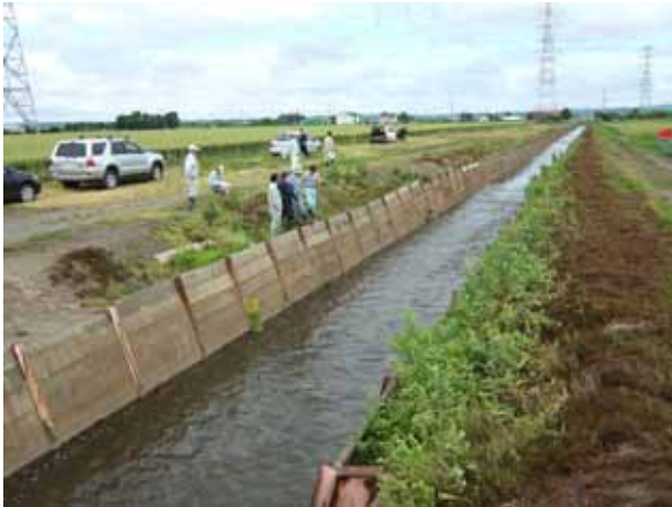
終点より 5 0 0 m の町道橋より上流方向 柵渠天端の不陸状況
