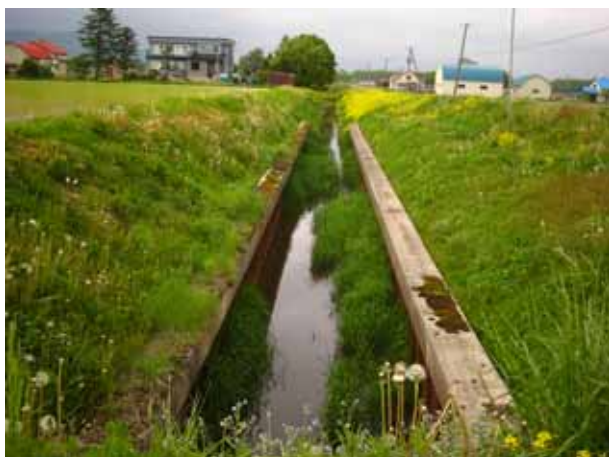
下流方向から宅地取付橋へ 土砂の堆積状況
