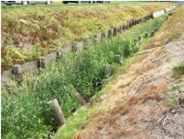
コンクリート杭による建込柵渠 RC パイル ( 300 ) の頭部破損状況 柵渠板の抜けている状況
