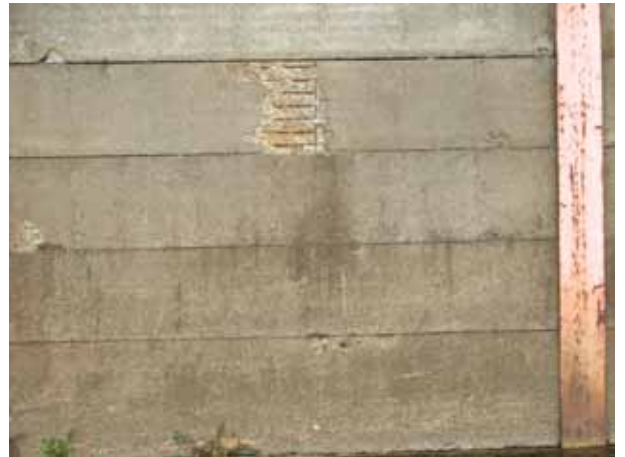
終点より 5 0 0 m 付近の L 側の柵渠 コンクリートの剥離状況、鉄筋の露出状況
