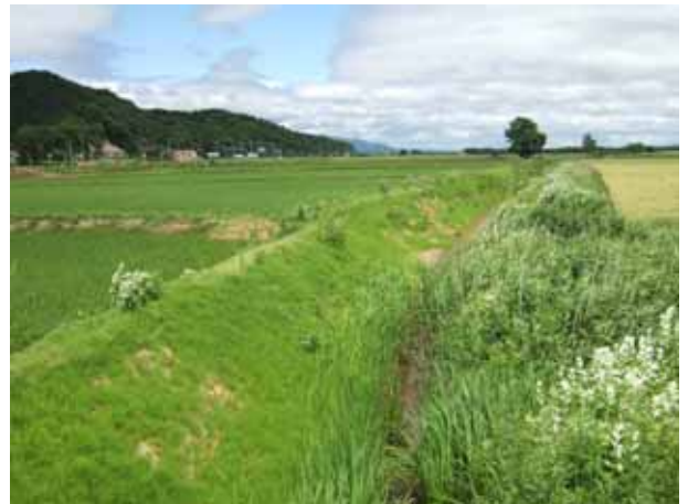
北 8 号橋から上流方向 法の崩れている状況・土砂の堆積状況
