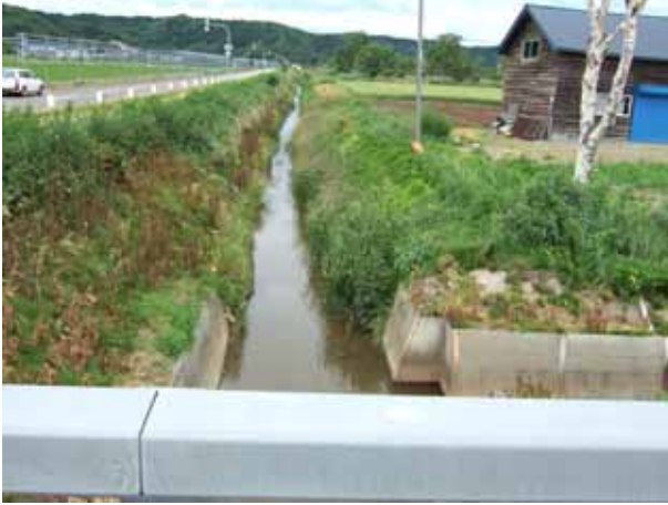
起点から上流方向 法のはらみ・土砂の堆積状況
