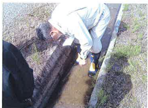
不等沈下 による湛 水（一部）
